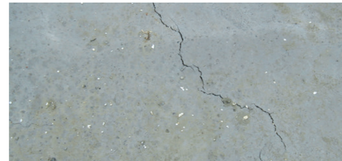
Fissures typiques de la dalle en béton dues au retrait plastique en raison d'une dessiccation précoce.
