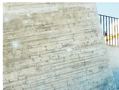
Figure 53 : Nid de gravier mastiqué au niveau du joint de coffrage
