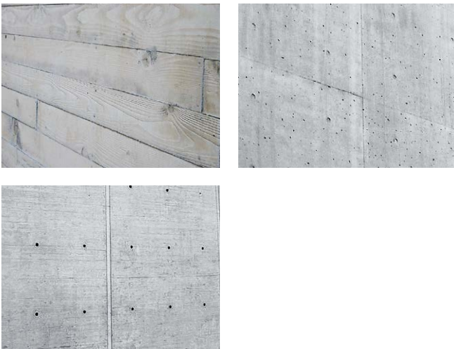
Figure 27 : Exemples de surface fermée et largement uniforme, avec des décalages, décrochements et empreintes des éléments de coffrage
