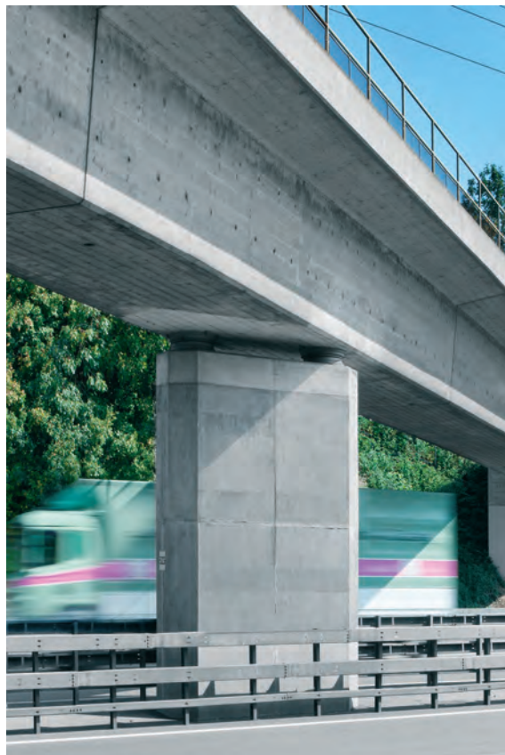
Rivestimento del pilone di un ponte con elementi in CFAP da 40 mm come protezione contro l'attacco da cloruri (anno di esecuzione: 2010).
